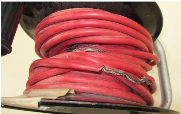
(b) 通電過熱事故を起こした電工ドラム
